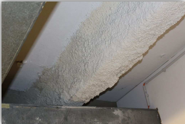
Abbildung: Spritzasbest (schwach gebundenes Asbestprodukt)
