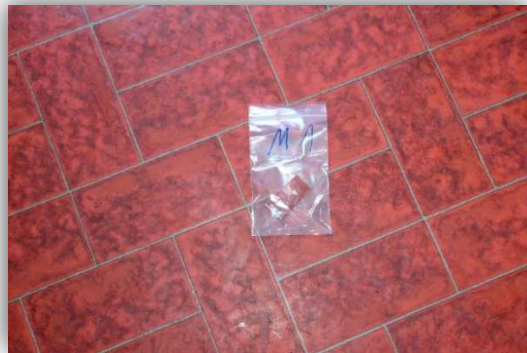
Abbildung: Cushion-Vinyl-Bodenbelag (Rückseitig aufgebraute Schicht enthält schwach gebundenes Asbest).
