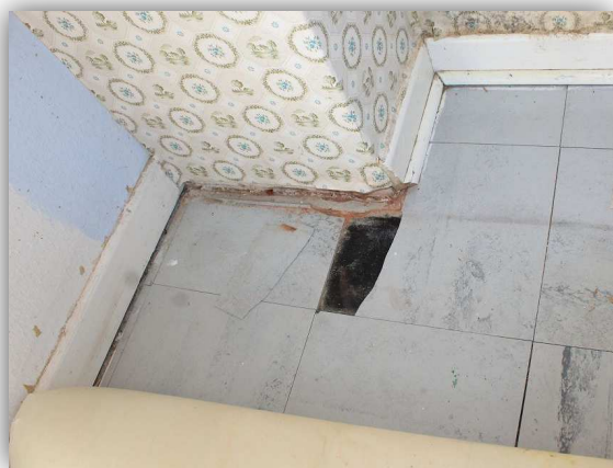
Abbildung: Asbesthaltige Flex-Platten und asbesthaltiger Kleber
